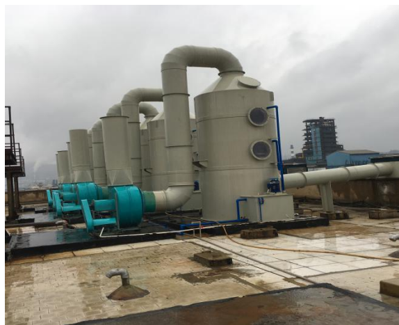
项目碱液喷淋吸收塔（共6套）
