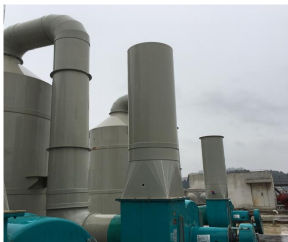
项目碱液喷淋吸收塔
