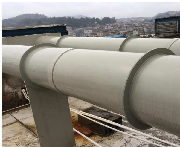
项目碱液喷淋吸收塔进气管道
