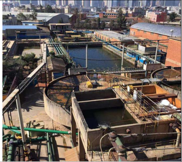
公司 11000m 3 /d 污水处理站
